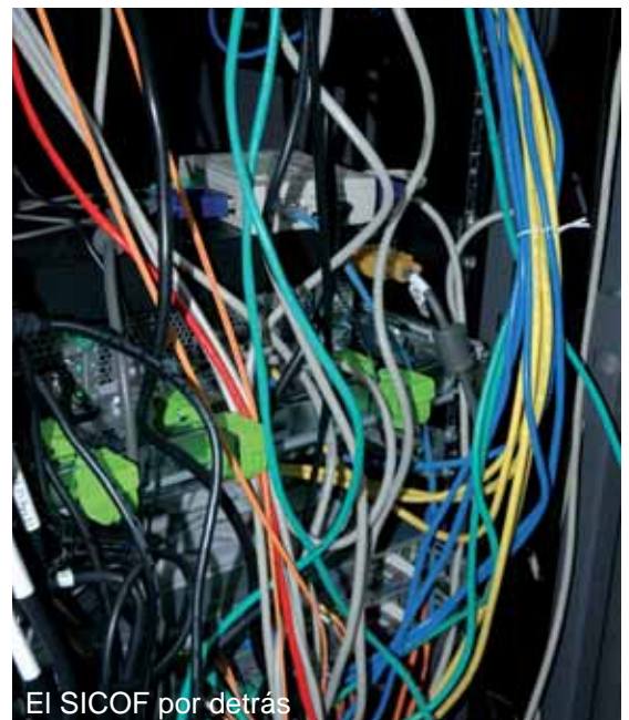
Las instalaciones del SICOF cuentan con un alto sistema de seguridad
